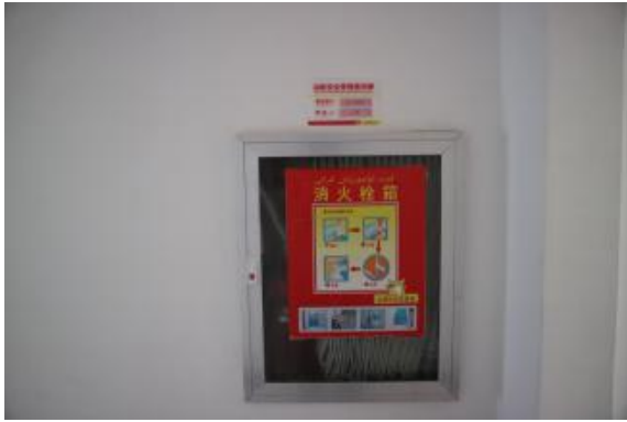
厂区消防应急设施
